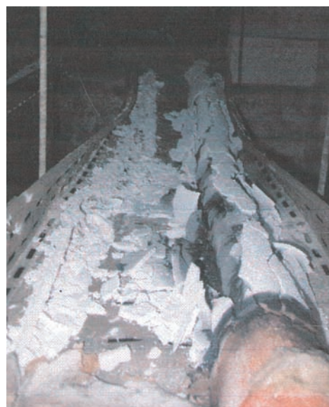
Вид кабельных линий после испытаний
